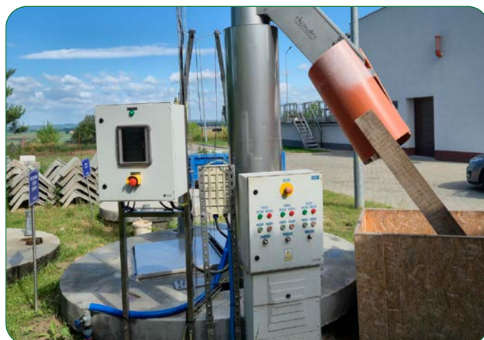
Zakup siła pionowego w przepompowni ścieków w Racinie, wartość inwestycji 246 tys. zł.
